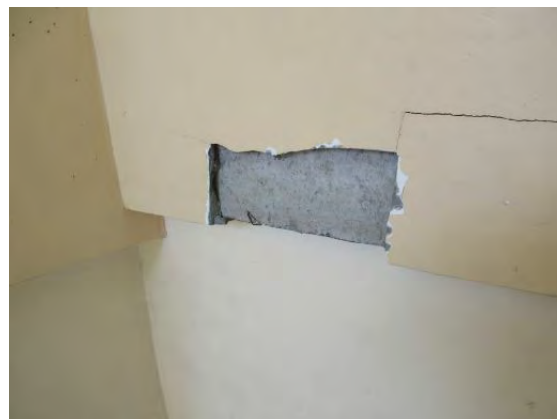
同左クローズアップ。仕上げの破損。
