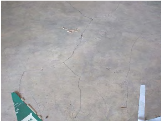
床のクラック。地震によるもの可能性があるとしている。
