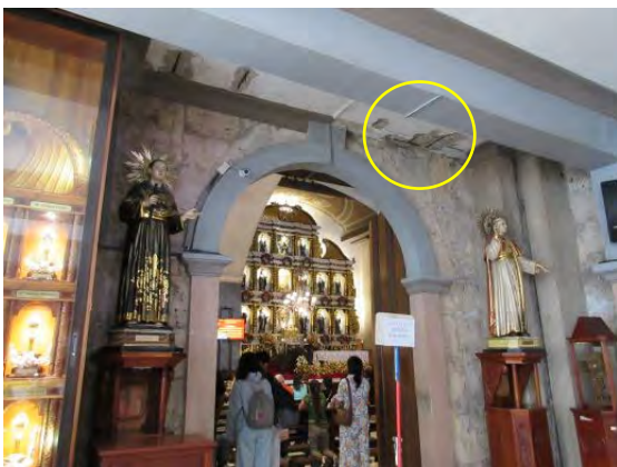
同上、内部の祭壇。アーチ外側の RC スラブ に鉄筋の爆裂が生じている
