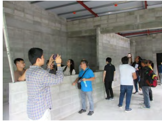
デモンストレーション会場敷地内の日本式 ブロック積による施工中建物の見学
