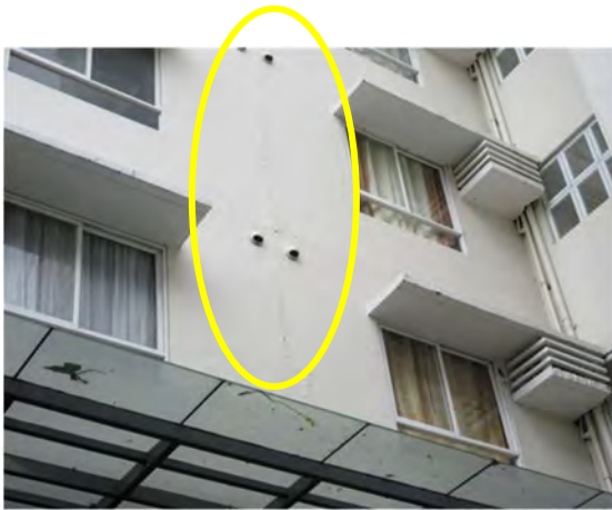
建物正面部分の仕上げの破損
