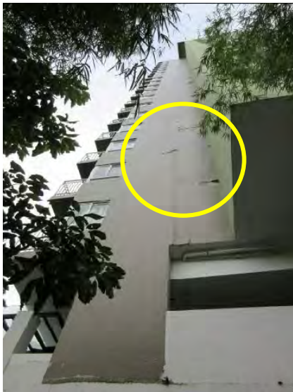
側面の壁面仕上げの被害
