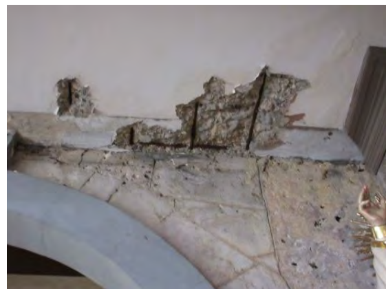
同左、RC スラブの爆裂の詳細
