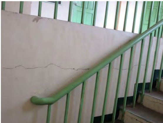
梁の下面のクラック
