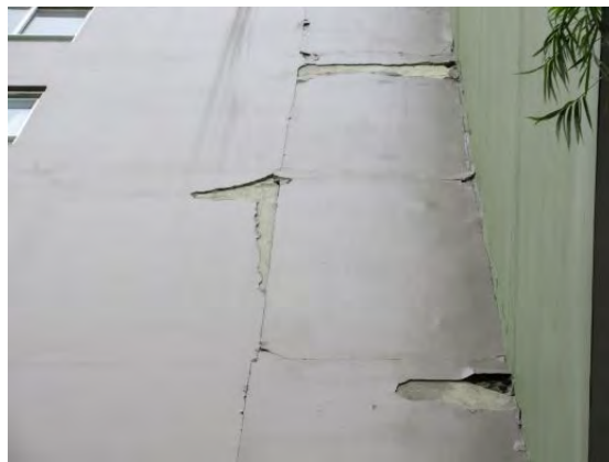
同左のクローズアップ。仕上げのモルタルの破損 (RCの壁柱とコンクリートパネルの外壁材の境界部分が破損)
