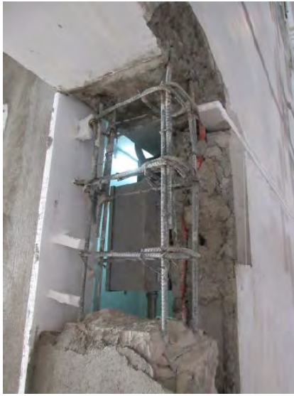
CHB 壁支持の RC 方立 (20x40 cm 程度) の上端部が破損。補修のため全面的に研って補修中。
