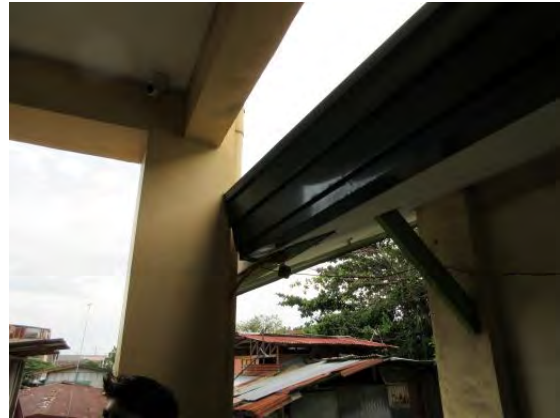
調査対象校舎(左)に、隣接の2階建て建物(右)の軒が入り込んでいる。
