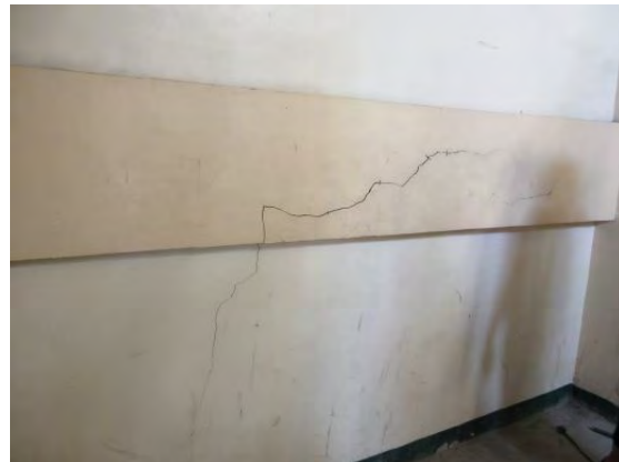
1-2階間踊り場梁のクラック。壁のクラックとつながっており、仕上げのクラックの可能性あり
