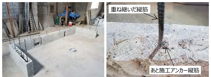
写真3 重ね継手縦筋の研り出し状況 写真4 研り出した重ね継手部の重ね継手部(No.10)
