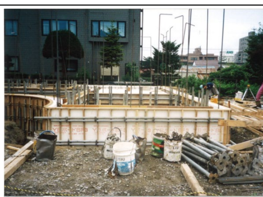
基礎の型枠工事中。すでにブロックの縦筋が、施工図の位置に建てている
