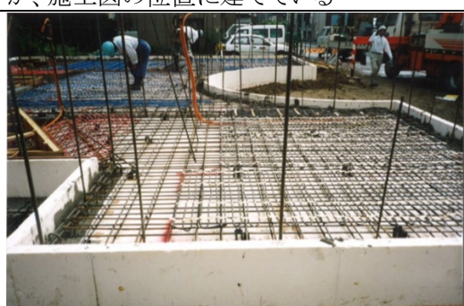
土間コンクリート下の土砂埋め戻し、砂利敷き、断熱材の敷き込み、土間コンクリート配筋を完了し、暖房用の配管工事中
