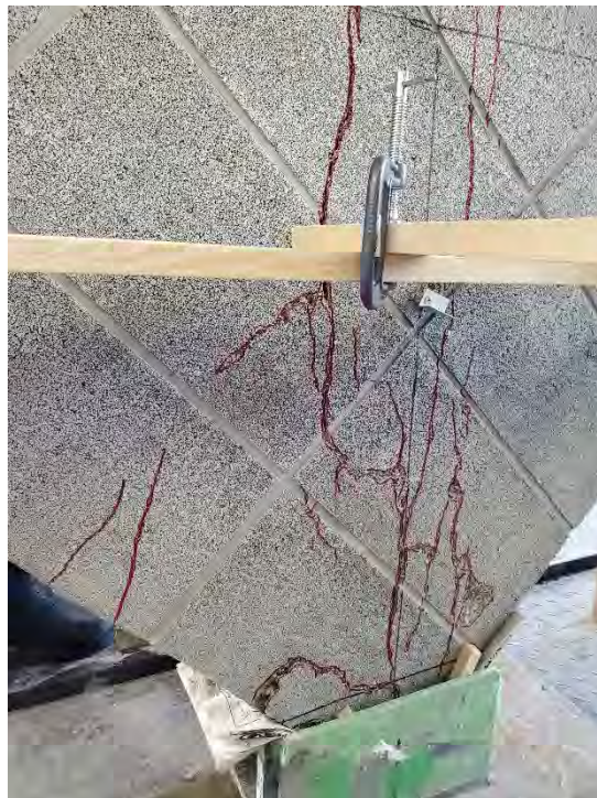
写真 5.6(2)-2 試験体 B の破壊状況(6):裏面の下端加圧部
