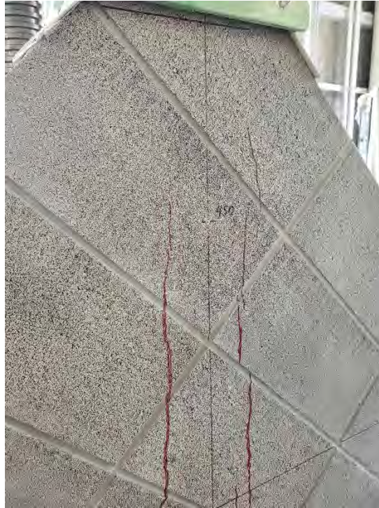
写真 5.6(2)-2 試験体 B の破壊状況(5):裏面の上端加圧部
