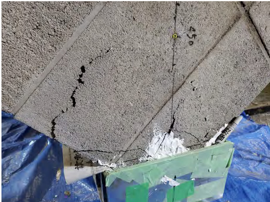
写真 5.6(2)-1 試験体 A の破壊状況(2):表面の下端加圧部
