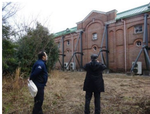
同左の背面。水平力を支持するバットレスが設置されている。
