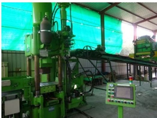
写真 8-1-3 JICA 供与の無焼成煉瓦の製造プラント(故障中)
