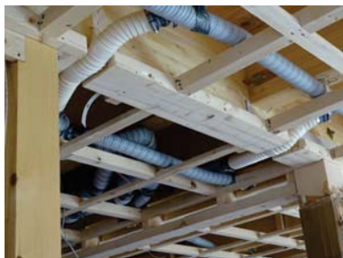
梁下に有効高さがなくダクト径を φ50mmに変更した例
