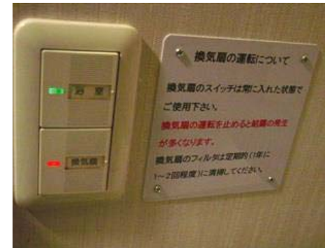
照明スイッチと同じスイッチ
