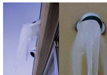
屋外排気フードのツララ
