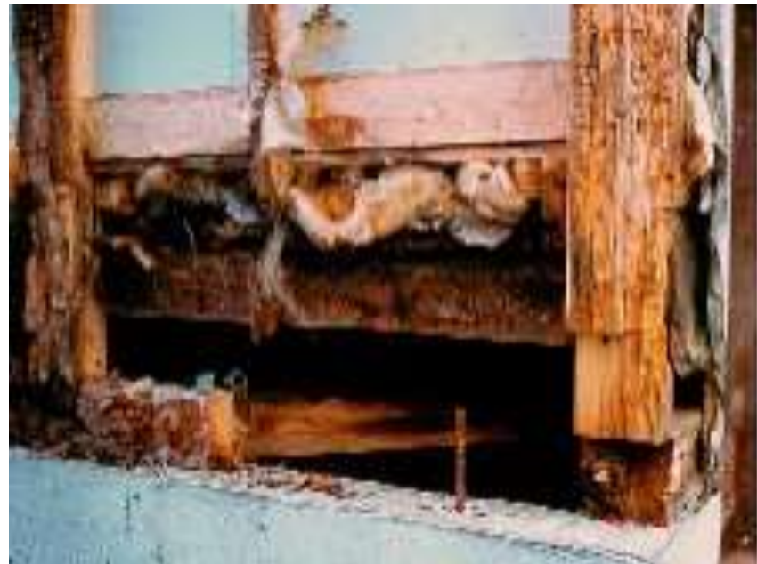
外壁張替え時に壁体下部の構造材
