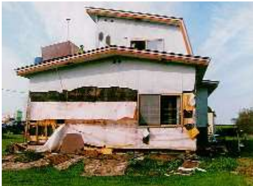
ダンマット工法による木材腐朽の例 の腐朽が発見された例
