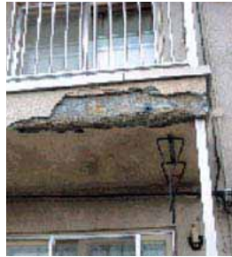
写真4：バルコニーの劣化
