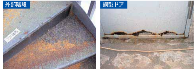
写真6：外部鉄部の錆び
